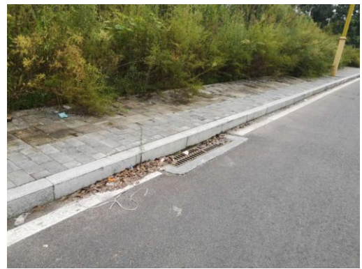
图 7.8 道路雨水设施（2）
