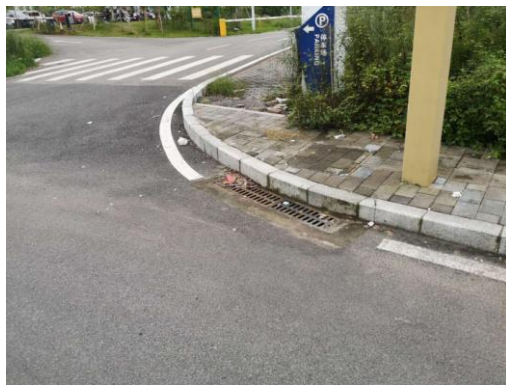
图 7.7 道路雨水设施（1）
