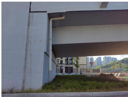
桥梁路面径流导排管
